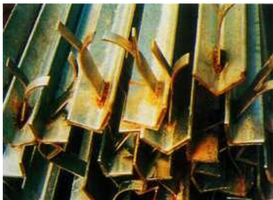
Abb. 18: Fehlstellen im Zinküberzug durch nicht entfernte Schweisschlacken
