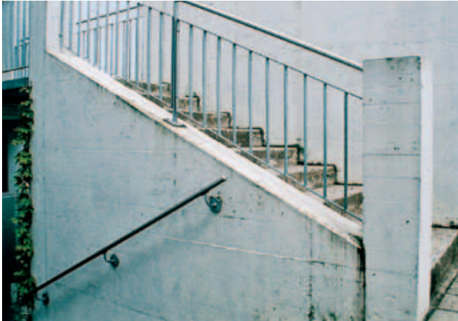
Treppen mit mehr als 5 Tritten: Handlauf zur Unterstützung beim Gehen, Staketengeländer als Absturzsicherung
