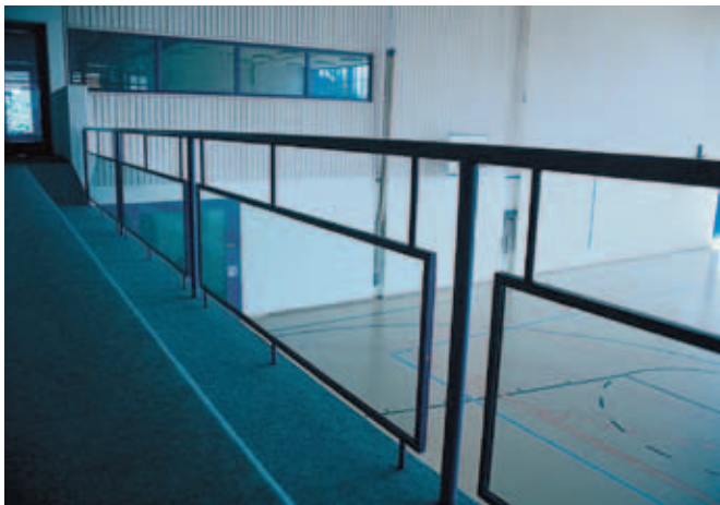
Absturzsicherung einer Zuschaueranlage mit Verbundsicherheitsglas, freie Sicht auf die Spielfelder, bis auf eine Höhe von 75 cm keine Öffnung grösser als \varnothing 12 cm
